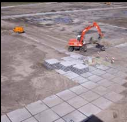
Toepassing Bouwwegen op bouwterrein Type Vloerplaat 200x200x14 cm met hoekrand, constructief gewapend Opdrachtgever Woningbouwvereniging Plaats Hoogerheide
